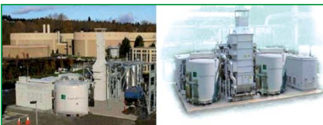
FIGURA 3 - I grandi impianti MCFC: a sinistra l'installazione di Washington del DFC1500 da 1 MW, a destra l'impianto DFC3000 da 2 MW di Indiana, USA [10,11]
